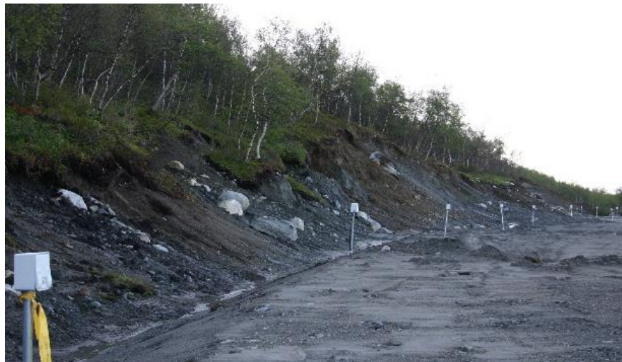
Kuva 3. Kaivettu Saanan rinne ruopuu sulamis- ja valuvesien aikaan.
